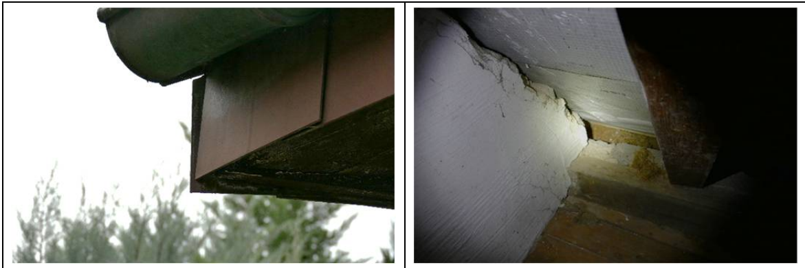
Abbildung 4: Öffnungen im Bereich des Dachüberstandes
